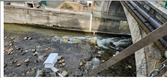
Caméra installée au pont de Soulom – Système d'endiguement du gave de Cauterets
