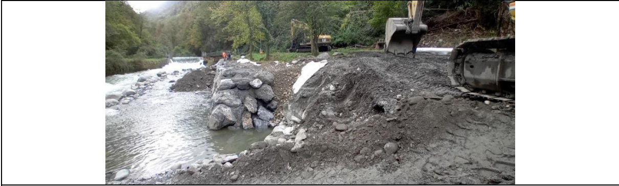
Mise en œuvre d'un enrochement bétonné en 2024 pour fermer le système d'endiguement du gave de Cauterets
