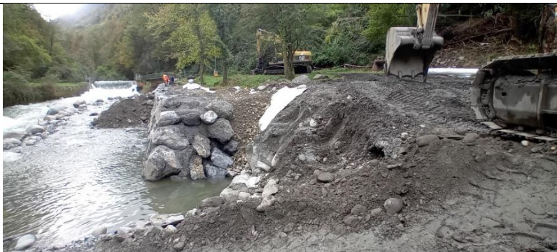
Mise en œuvre d'un enrochement bétonné en 2024 pour fermer le système d'endiguement du gave de Cauterets
