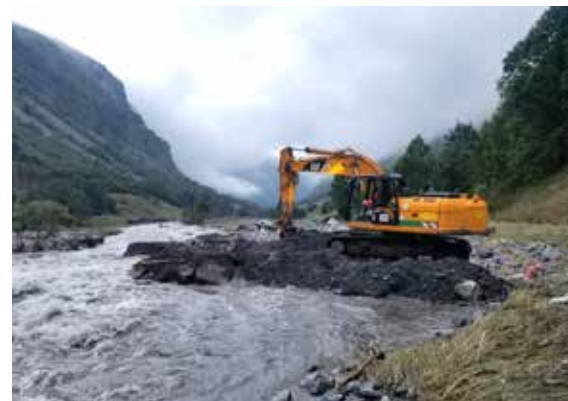
📷 Intervention du PLVG lors de la crue majeure du 07/09/2024 à Héas
